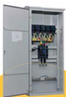
Verteilerschrank Reduktion der Leitungen zur nächsten Trafo- Station.
